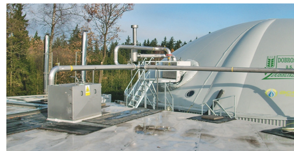
Inovované servisní šachty umožňují přístup k míchadlům během provozu. V pozadí stojí (podle vyjádření dodavatele) v současnosti nejvyšší plýnojem v ČR
