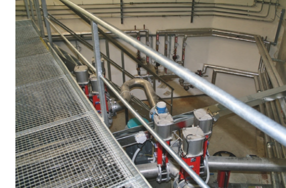
Plně automatizovaná strojovna je založena na důmyslnosti a kvalitních nerezových materiálech
