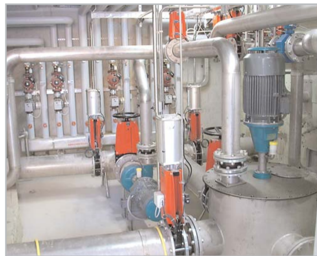
Plně automatizovaná strojovna s registrem potrubí Foto archiv
