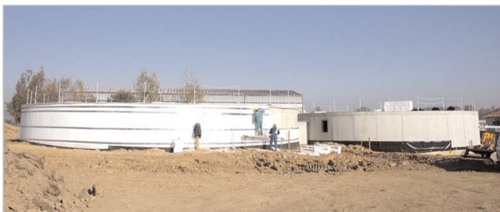
Vnější zateplení dofermentorů tvoří deset centimetrů silný polystyrén (v zapuštěné části extrudovaný)
