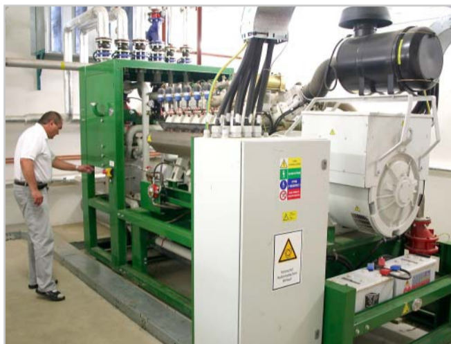
Dvě kogenerační jednotky MAN jsou vzájemně zastupitelné při servisních úkonech Foto Jiří Trnavský
