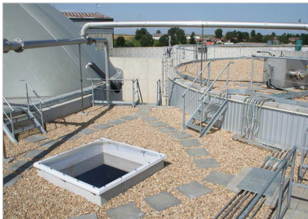
Centrální vělín s průhledem spojuje dva fermentory, dofermetor s plynojemem a nádrž na digestát Foto Jiří Trnavský
