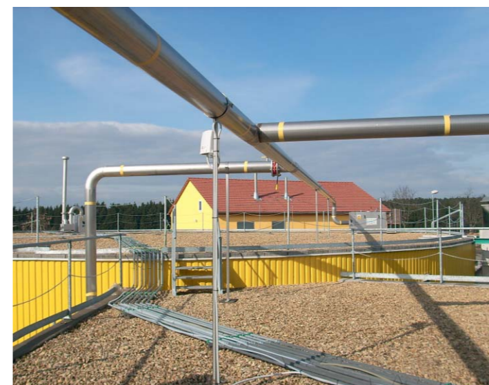
Bioplyn z fermentorů je veden k budově kogenerace nerezovými potrubím
