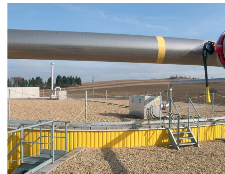
Úhledné zakrytí tepelně izolovaného stropu fermentoru se servisními šachtami
