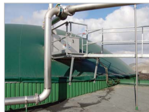
Servisní šachta umožňuje přístup k míchadlům během provozu
