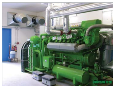
Kogenerační jednotka o elektrickém výkonu 526 kW
