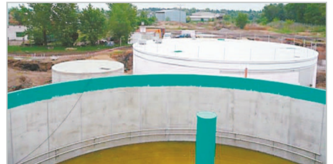
Důležitá je ochrana laminací na vnitřní části prostoru fermentoru nad hladinou substrátu proti působení agresivního bioplynu
