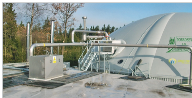
Plynojem musí být ve vysoké kvalitě a s přístupem pro servis míchadel během provozu
